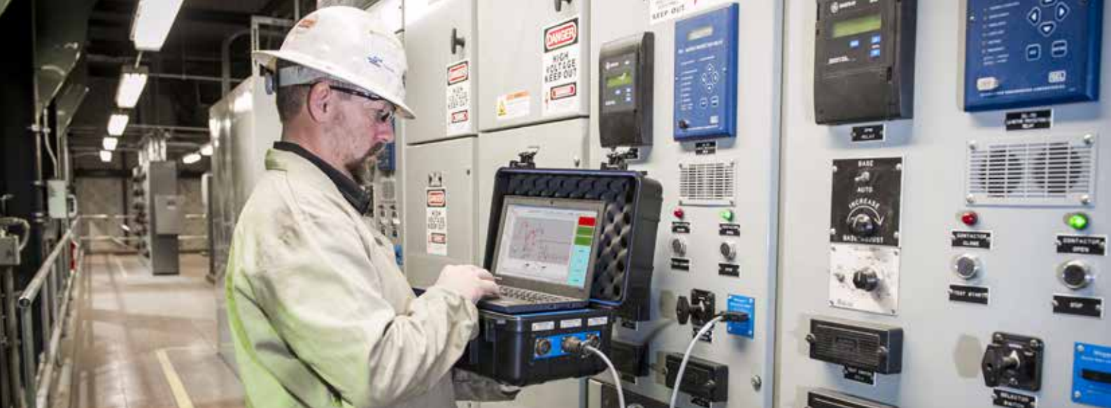
一位技术人员使用连接到电机控制柜的EP1000上的EXP4000分析仪
